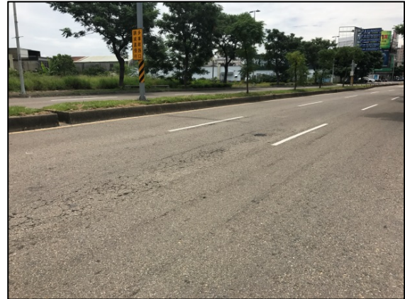
既有路面老化龜裂
