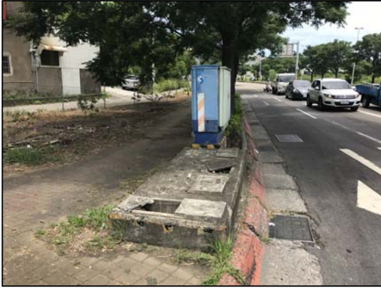
未設置無障礙坡道
