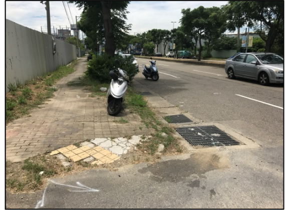
人行道鋪面損壞
