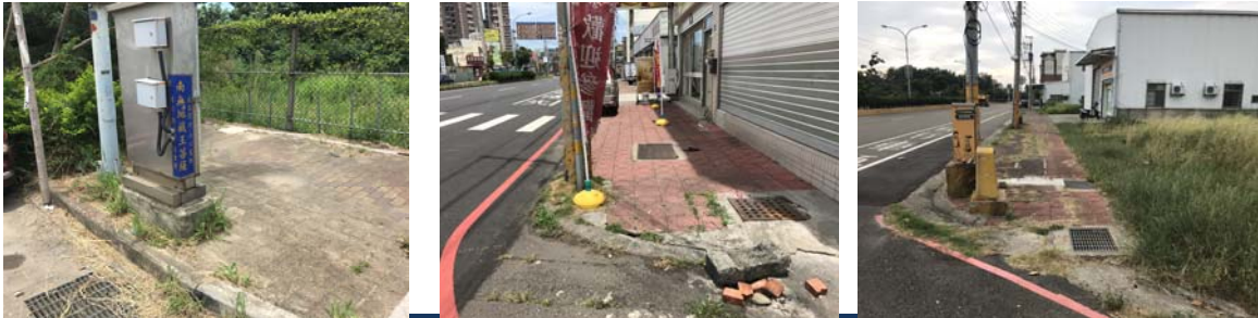
既有人行道旁鋪面凌亂破損，使用機能偏低，景觀環境雜亂無特色
