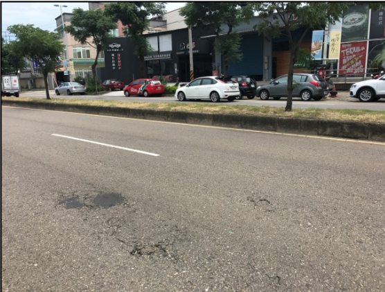
既有路面坑洞破損
