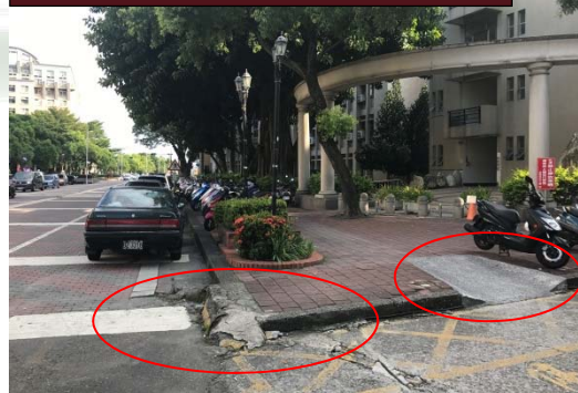
人行道緣石破損及舂箕型無障礙坡道現況照片
