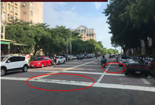
連鎖磚鋪面破損不平整道路現況照片
