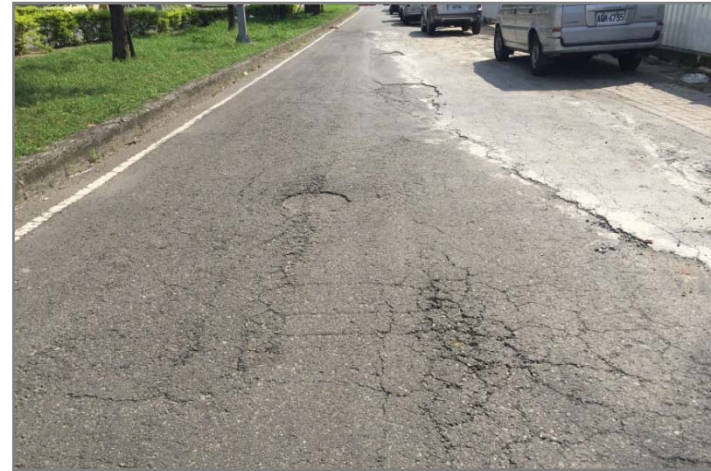
▲ 慢車道老舊破損龜裂
