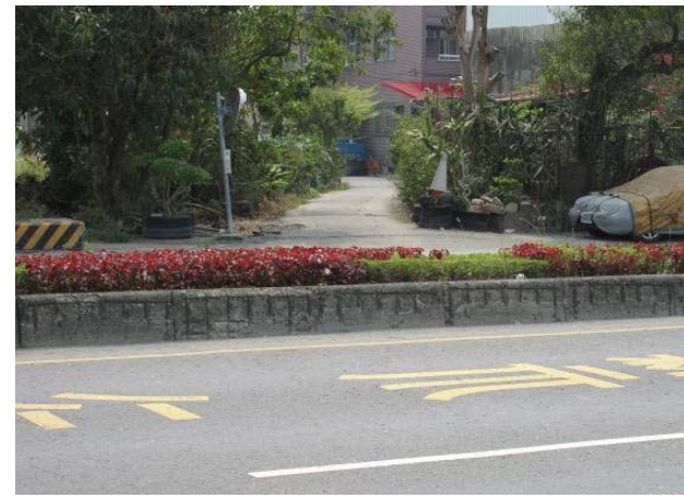
▲分隔島緣石老舊破損、鋼筋裸露
