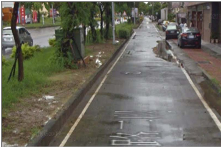
▲ 慢車道排水不良
