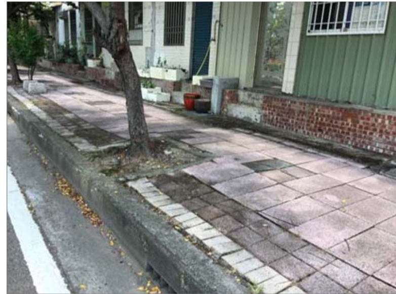
▲人行道鋪面老舊破損且樹穴附近有竄根現象，導致不平整
