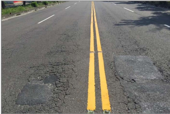
▲ 路面龜裂、多處局部修補導致不平整
