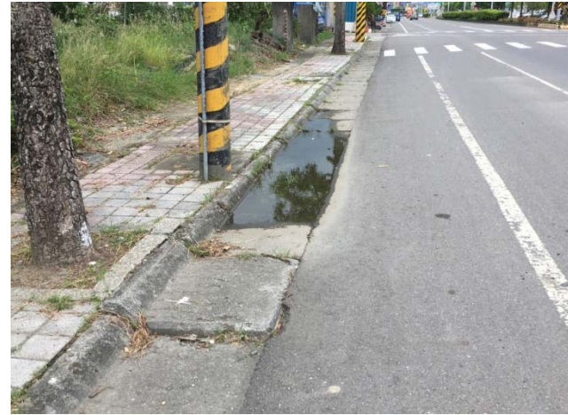
▲多處排水不良易積水、管線尚未下地
