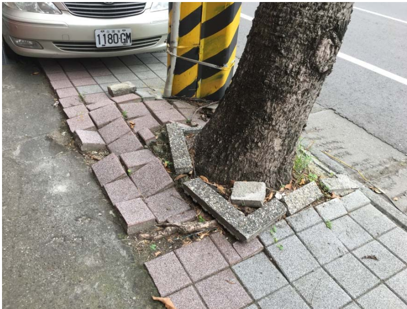
▲人行道磚不平整、多處竄根現象
