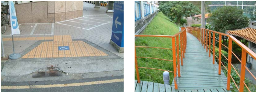
圖 3-26 坡道坡度不符規定
