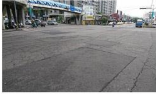
原有瀝青路面龜裂、不平整
