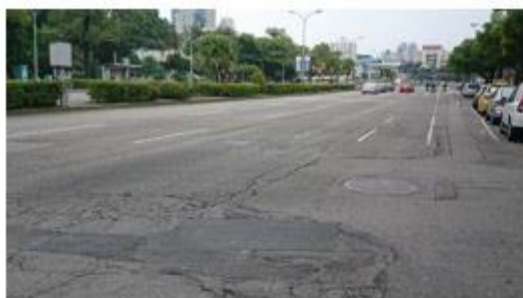
管線孔蓋眾多、瀝青路面龜裂
