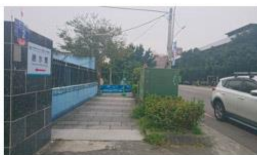
變電箱體設備佔據人行空間
