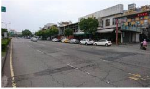
原有瀝青路面龜裂、不平整
