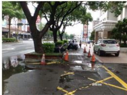
(D)人行道鋪面狀況不良
