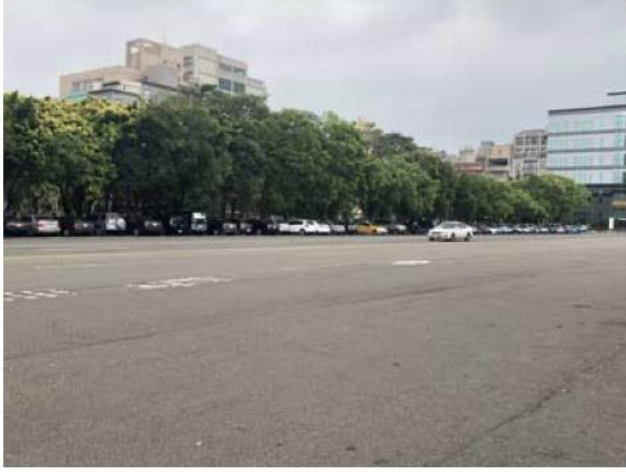
(A)路面龜裂不平
